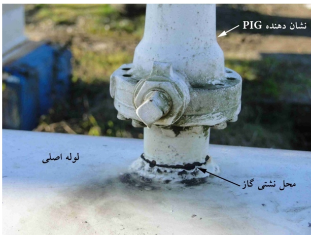
شکل 1- شیار ایجاد شده در جوش اتصال نشان دهنده‌ی PIG به لوله‌ی اصلی
